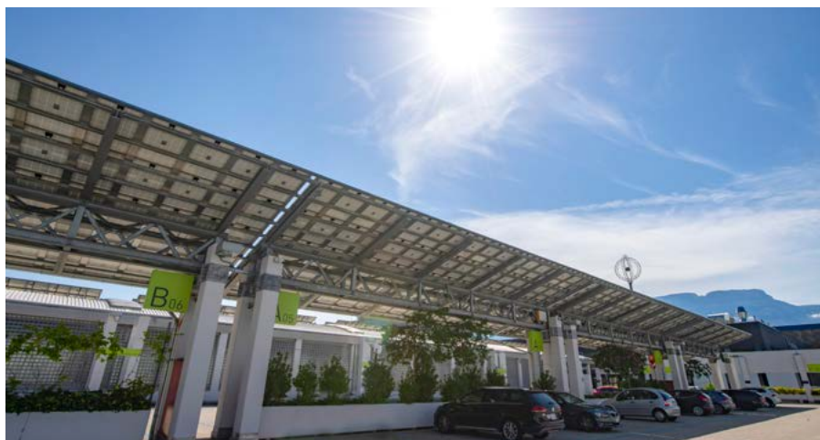
PV-Anlage als Dach der Autostellplätze bei der Messe Bozen
