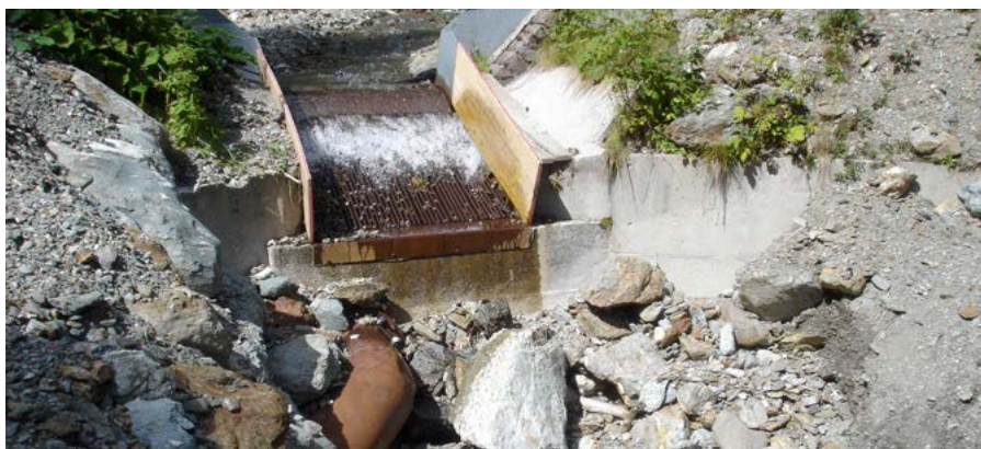
Dies ist traurige Realität an vielen bereits bestehenden Kleinkraftwerken. Die minimale Produktion dieser rund 850 Werke in Südtirol (unter 3%) steht in keinem Verhältnis zum ökologischen Schaden.
